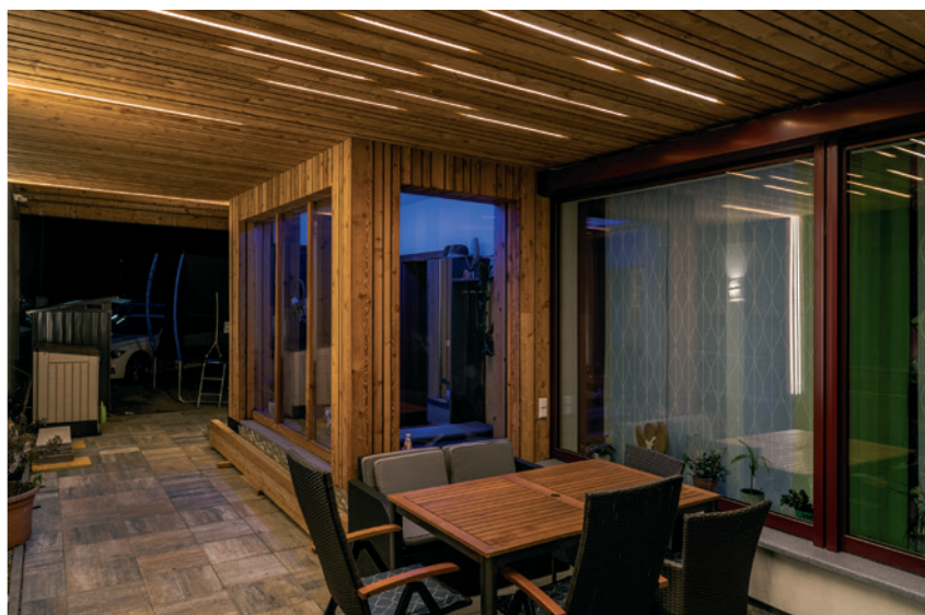
LED-Streifen wie diese von Bilton in der Holzverkleidung sorgen auf der Terrasse dieses Einfamilienhauses für genügend Licht, etwa im Ess- oder Eingangsbereich.
